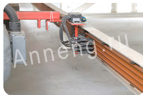
Пример установки токосъемника
